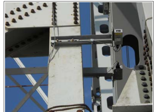
Abb 2: Laser Sensor montiert an Stahlkonstruktion
