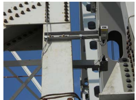
Abb 2: Laser Sensor montiert an Stahlkonstruktion
